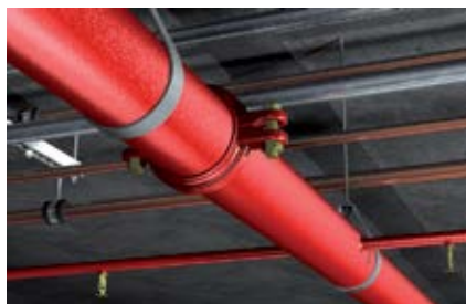
Системы аварийного пожаротушения
